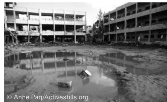
École gravement endommagée dans le quartier Shujaiya pendant l'attaque en l'été 2014 ; ville de Gaza, novembre 2014
